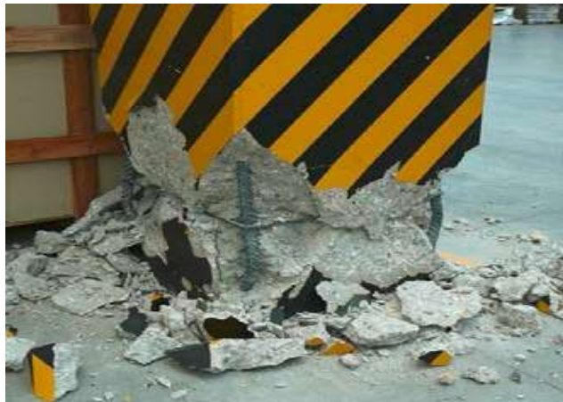
Cerniera plastica alla base del pilastro
