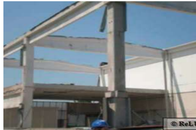
Perdita di appoggio dei pannelli di copertura
