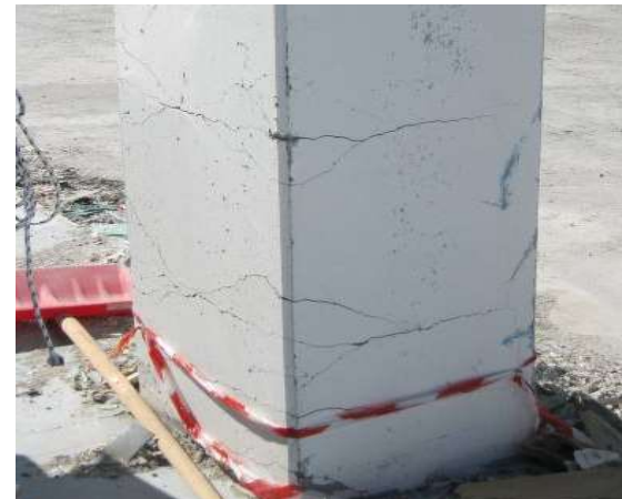
Fessurazione alla base del pilastro
