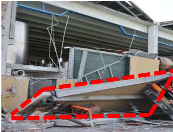
Distacco dei tamponamenti
