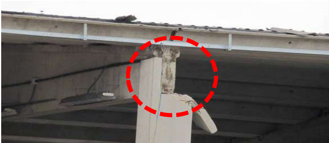
Insufficiente resistenza della forcilla
