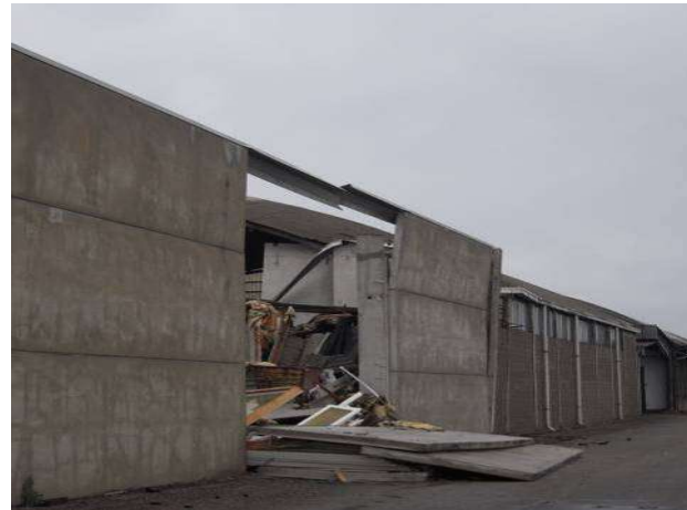
Distacco dei tamponamenti
