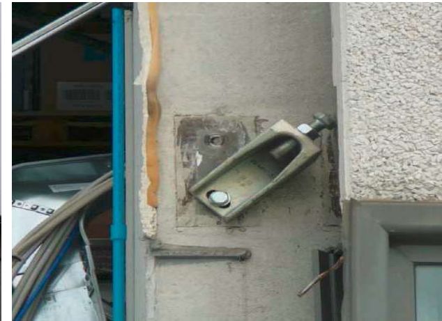
Rottura attacco della mensola di supporto pannello e conseguente crollo del pannello
