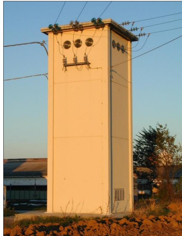
Cabina entra/esci in elevazione
