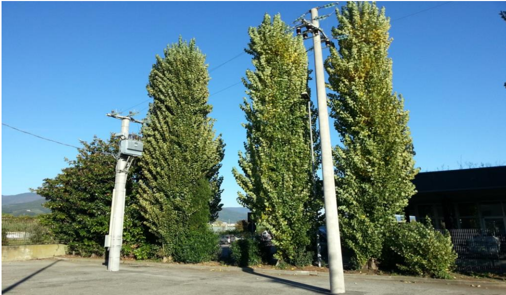
Posto di trasformazione su palo (PTP)
